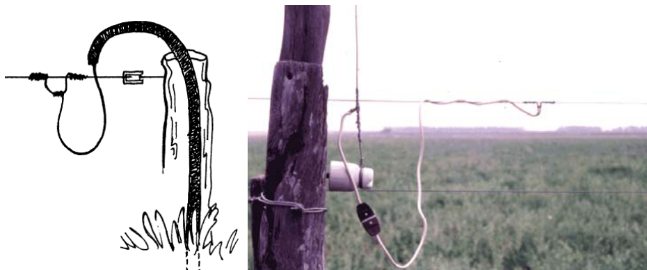
Figura 39.- a)-Utilización de cables de cobre. b)- Conexión central a la línea madre con cable de cobre estañado y enchufe.
