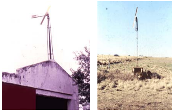
a)-Central eléctrica: aerocargador sobre un galpón. b)-Aérocargador para eléctrico en plena sierra del Comechingones; equipo protegido por una heladera en desuso.
